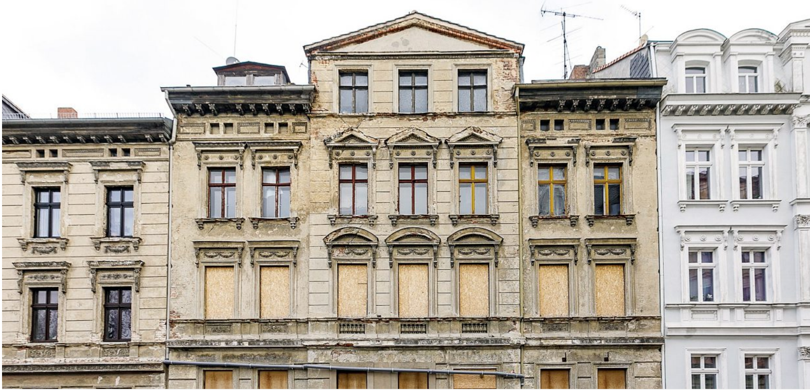
Das Haus Bahnhofstraße 54, gelegen stadtauswärts links zwischen Schiller- und Blockhausstraße, ist einsturzgefährdet.
